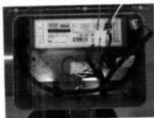
Vista interna da luminária
